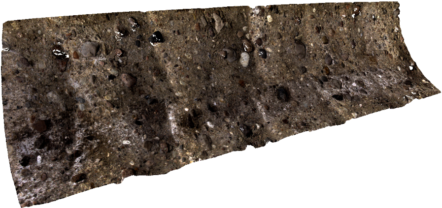
Abb. 6: Ausschnitt DN400 Betonrohr mit groben Gesteinseinschlüssen (gestitched)
